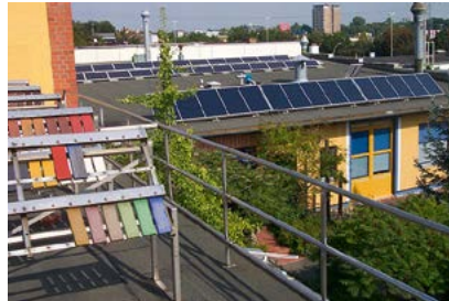
Photovoltaik- und Solarthermieranlagen
